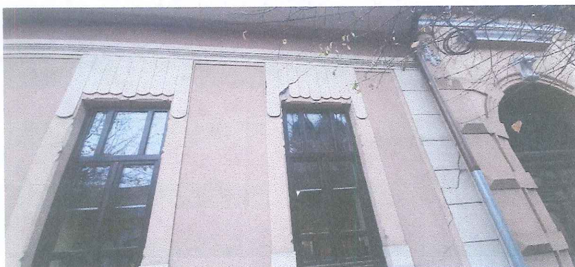
DEGRADAREA TENCUIELII EXTERIOARE, FISURI ÎNCLINATE LA COLȚUL DIN DREAPTA A CLĂDIRII
