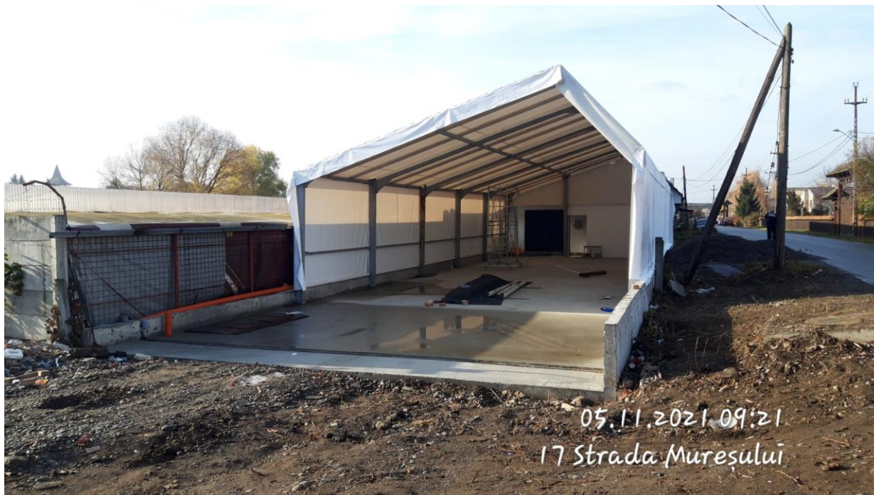
Clădire realizată fără Autorizație de Construire
