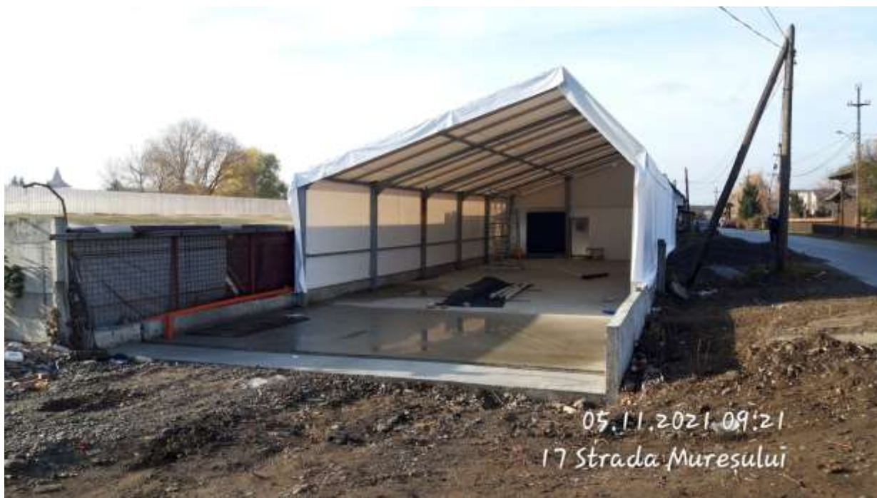
Clădire realizată fără Autorizație de Construire
